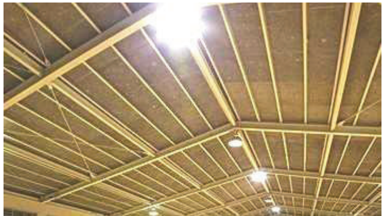
工場などの天井に設置
